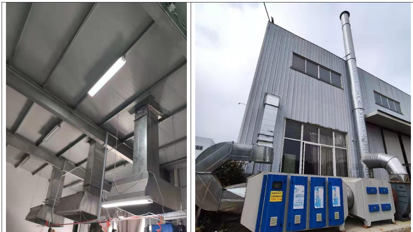
图4.1-1 有机废气收集处理设施图
